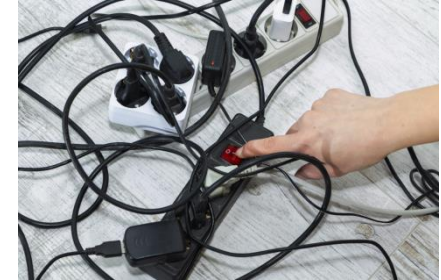
Kaskaden nicht zulässig!
